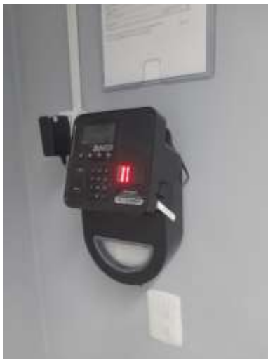
EQUIPAMENTO DE TI
